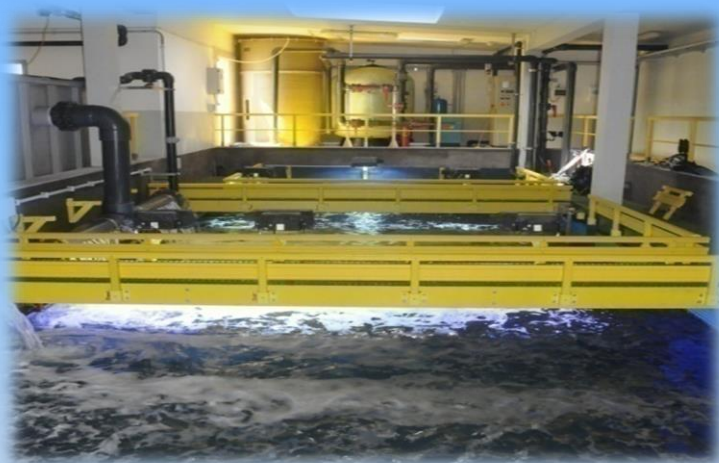
Locali tecnici dell'Acquario di Cala Gonone
